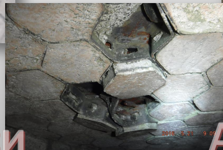
Выдавливание бетона из ячейки панцирной сетки.
